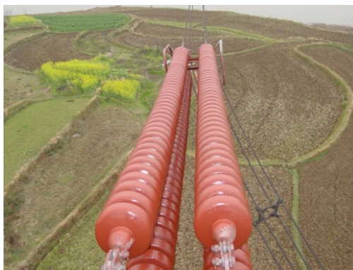
Figure 3. Composite insulators 图 3. 复合绝缘子
