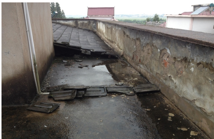
Figure 6. Leaking roof 图 6. 屋顶漏水
