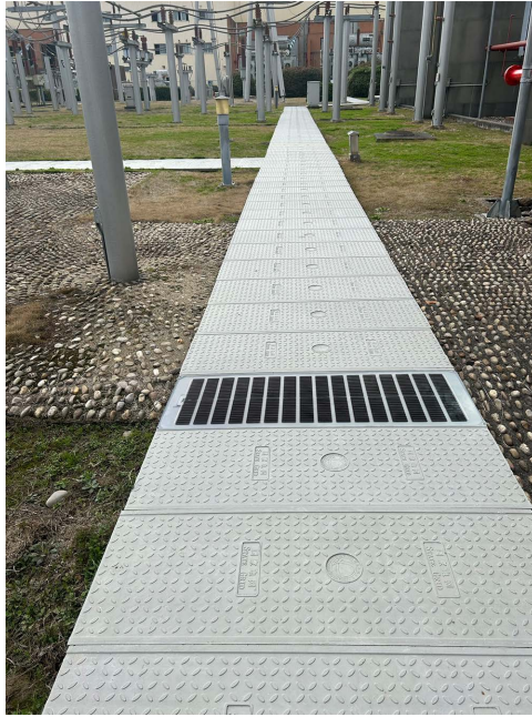
Figure 4. Actual application effect of intelligent cable trench cover plate 图 4. 电缆沟智能盖板实际应用效果图
