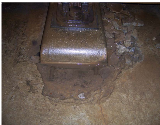
Figure 2. Sleeper loose of SUI-YU line 图 2. 遂渝线无砟轨道轨枕松动
