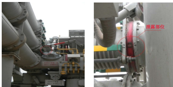
Figure 4. Leakage location 图 4. 泄漏部位
