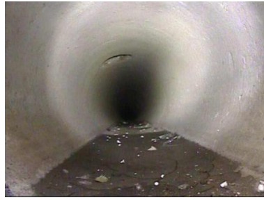
Figure 1. Original image of pipeline 图 1. 管道原始图像
