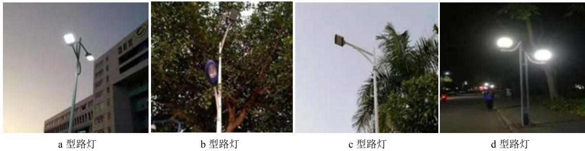
Figure 1. Street lamp type 图 1. 路灯灯型
