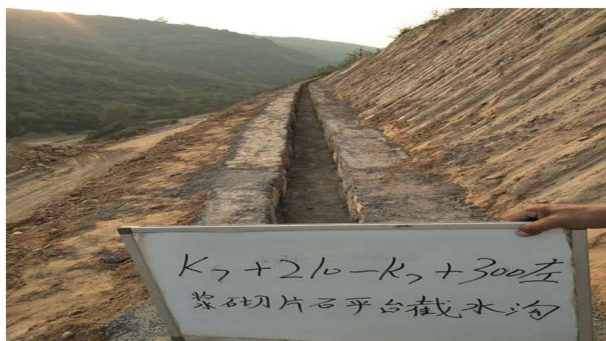
Figure 3. Interception ditch 图 3. 截水沟
