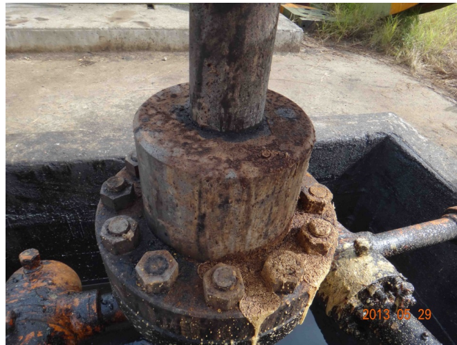
Figure 5. Foam carbide behave in wellsite 图 5. 现场使用泡沫涂抹井口发生碳化现象
