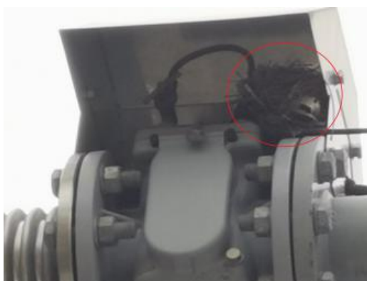
(a) 主变瓦斯继电器
