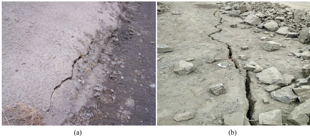
Figure 3. Road cracks 图 3. 道路裂缝
