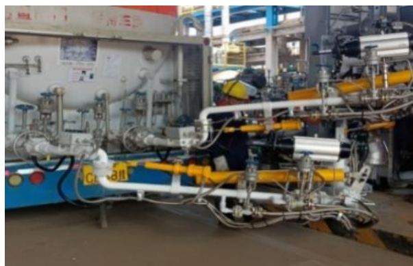
Figure 12. Actual application in Qingdao 图 12. 青岛现场实际应用
