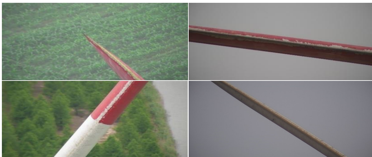
Figure 9. Partial example of a dataset for wind turbine blade defects 图 9. 风机叶片缺陷数据集的部分示例
