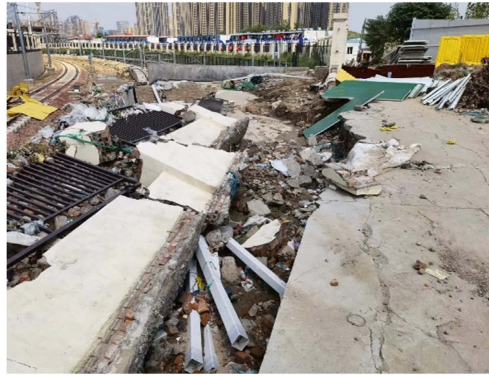
Figure 4. Wall collapse 图 4. 围墙垮塌
