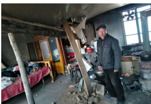
Figure 4. The roof collapse of mud-timber roof structure 图 4. 松原地震中的土坯 - 木屋顶结构的屋顶垮塌
