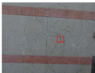
Figure 5. Original image of crack in exterior wall 图 5. 大楼磁砖裂缝原始图像
