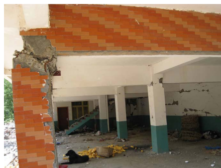
Photo 26. y39-1 the detail part of photo y39, steel bars exposed and yielded 照片 26. y39-1 照片 y39 的细部图片，可见柱子钢筋裸露、屈服
