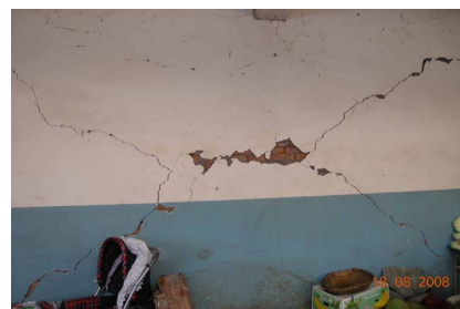
Photo 19. z20-1 the detail part of photo z20, X cracks on bearing walls 照片 19. z20-1 照片 z20 的细部图片, 可见承重墙出现 X 裂缝
