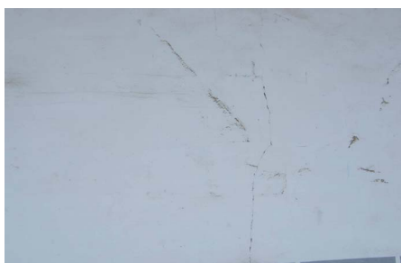
Photo 12. q9-1 the detail part of photo q9, visible small cracks on the wall 照片 12. q9-1 照片 q9 的细部图片，外墙可见小裂缝
