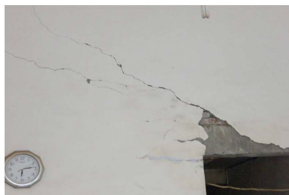
Photo 14. q14-1 the detail part of photo q14, visible cracks on the wall
