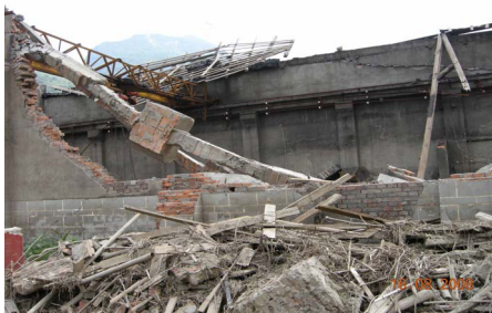
Photo 29. d30 most structural damage, the roof collapsed, judged as collapse 照片 29. d30 大部分结构构件损毁，屋面整体倒塌，判定为倒塌
