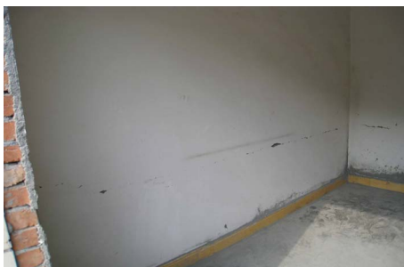
Photo 17. z10-1 the detail part of photo z10, horizontal cracks on the wall 照片 17. z10-1 照片 z10 的细部图片, 可见墙体有横裂缝, 隔墙破坏
