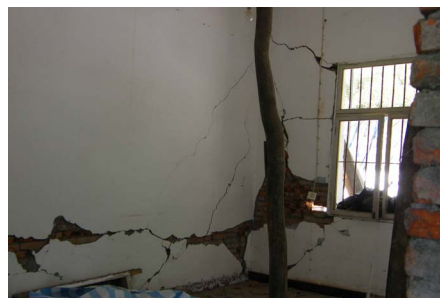
Photo 24. y17-2 the detail part of photo y17, horizontal and vertical cracks on the wall 照片 24. y17-2 照片 y17 的细部图片，可见承重墙出现水平通缝
