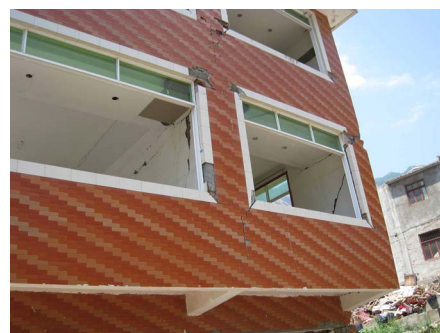
Photo 27. y39-2 the detail part of photo y39, overhanging wall in second floor cracked 照片 27. y39-2 照片 y39 的细部图片，可见二层悬挑墙体开裂
