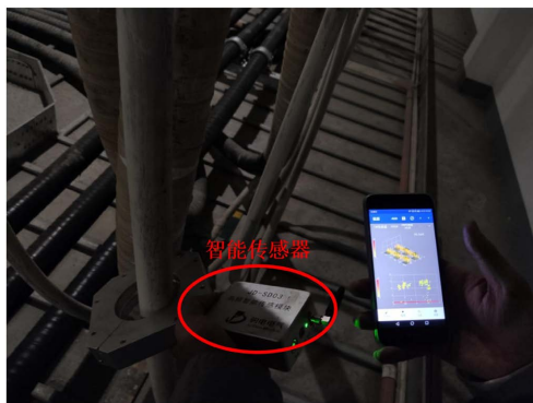
Figure 5. Cable mezzanine field test photos 图 5. 电缆夹层现场测试照片
