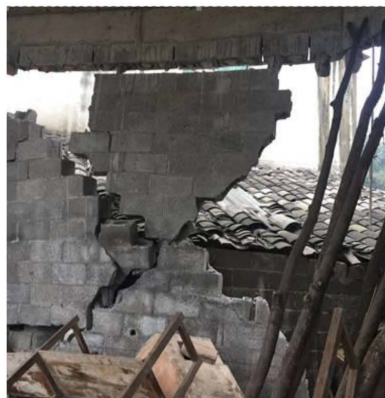
(e) 中坝村砖木结构“X”贯穿性裂缝
