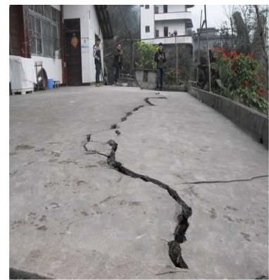
(f) 乐义乡黄金村地面裂缝
