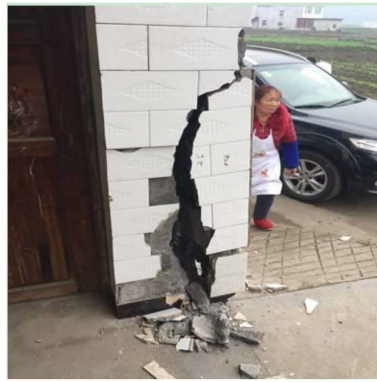
(b) 黄金村砖混结构墙角柱子扭断
