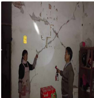
(d) 乐义乡黄金村 7 组砖混结构房屋“X”裂缝
