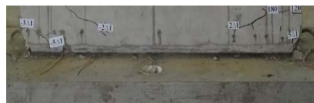
(a) 墙身损伤
