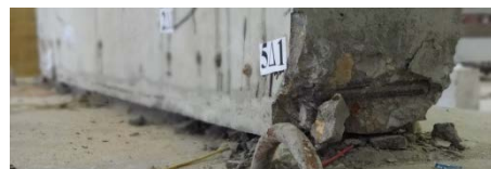
(b) 墙角损伤
