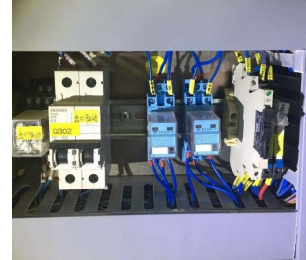
继电器安装完成图
