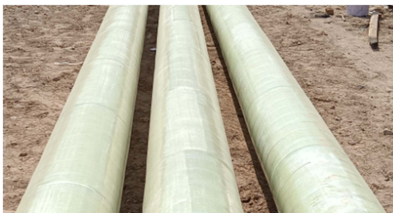
Figure 2. CND400 photosensitive curing FRP cladding completed 图 2. CND400 光敏固化玻璃钢包覆完成
