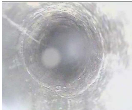
1.35 m-环向裂隙
