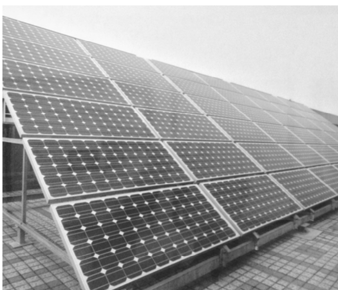
(a) 屋顶光伏电池板
